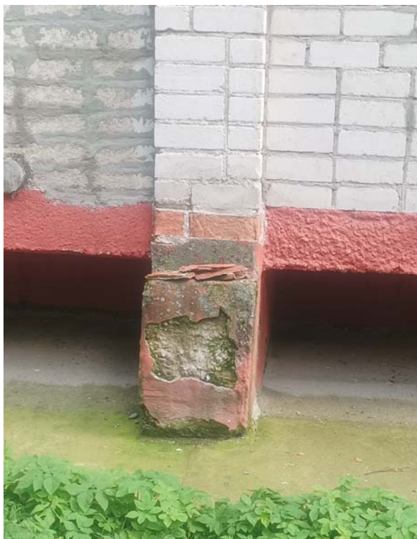
Фото 39. Разрушение штукатурного покрытия блоков ФБС по оси 8 в уровне первого ряда блоков фундаментных стен лоджий (Деф 3)
