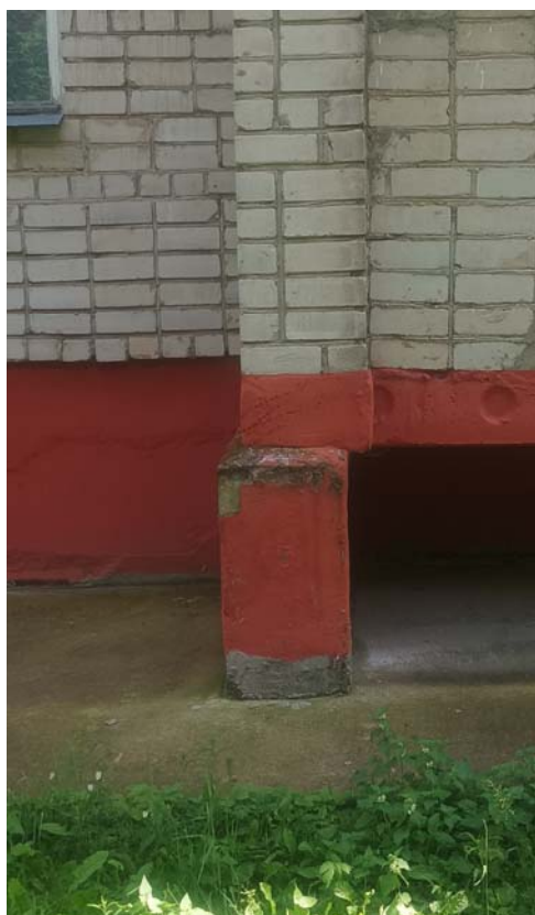
Фото 40. Смещение вертикальной оси кирпичной стены от вертикальной оси фундаментной стены по оси 15 достигает 50мм (Деф 2)
