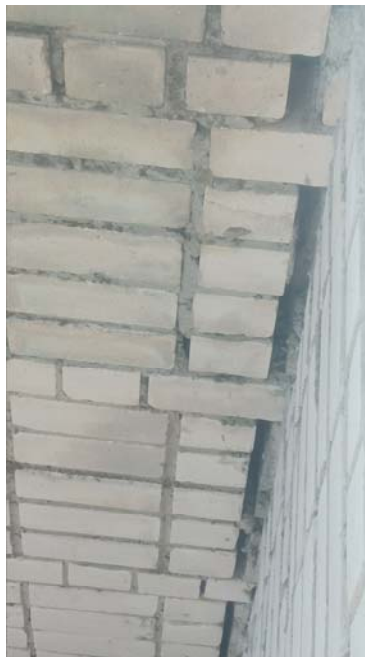
Фото 5. Лоджия №1, стена по оси 1, трещина отделения стены лоджии от наружной стены здания достигает раскрытия 30 мм (вид изнутри лоджии) (Деф 1)
